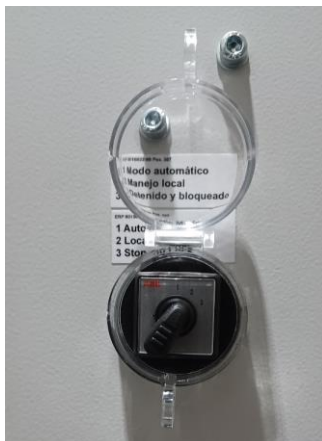
Para desactivar las comunicaciones en remoto se abre la tapa y se gira el selector poniéndolo en posición 2 ó 3, dependiendo del trabajo a realizar. To remove remote communications, turn the selector to position 2 or 3, depending on the work to be done.
